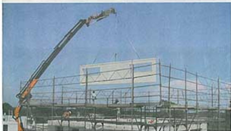
Préfabriquée en atelier, l'enveloppe de la maison est ensuite acheminée par camion, ce qui permet un gain de temps considérable sur les chantiers.
